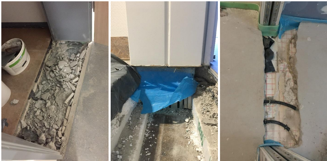
Abbildung 10-1 Aufnahmen von nachträglichen Stemmarbeiten an Estrichen im Tür-Durchgangsbereich, links und mittig nachträglich, rechts noch während der Bauzeit
