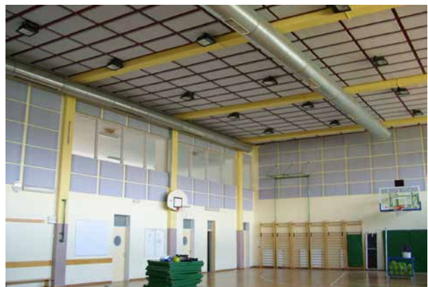
Decke, Wände mit Akustikpaneelen
