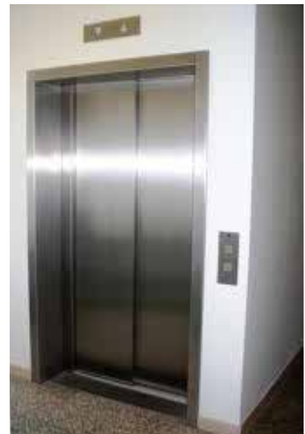
Abb. 18: Aufzug mit Stahlblechtüren
