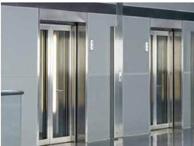
Abb. 19: Aufzug mit Glastüren
